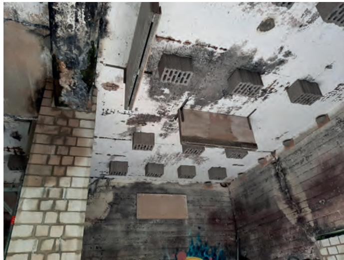
Isolierte Spaltenquartiere an Wand und Decke sowie Hohlblocksteine an der Decke des Pumpenhauses, gemauerte Stützsäule links.
