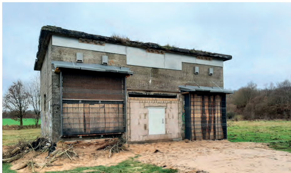
Südseite des Pumpenhauses mit Einflugsplatt für Fledermäuse zum Winterquartier, Fassadenblechen und Kunsthöhlen an der Außenfassade zur Sommerquartiernutzung, Mehlschwalbenkästen, Insektenhotels (ges. ca. 12 m 2 ), Sandschüttungen als Eiablage- und Sonnenplätzen für Zauneidechsen. Bild: R. Seifert
